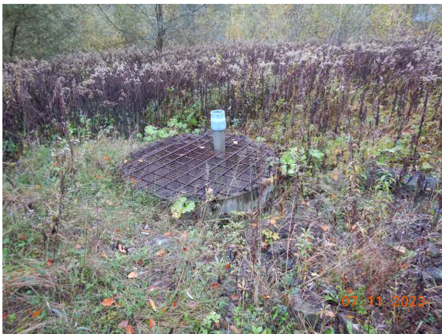
Messstelle Schacht 1 (Sammelschacht – S1)
